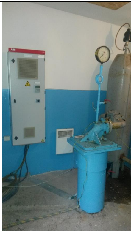
Foto 5.10 Siiverts'i puurkaevpumpla sisevaade 2
