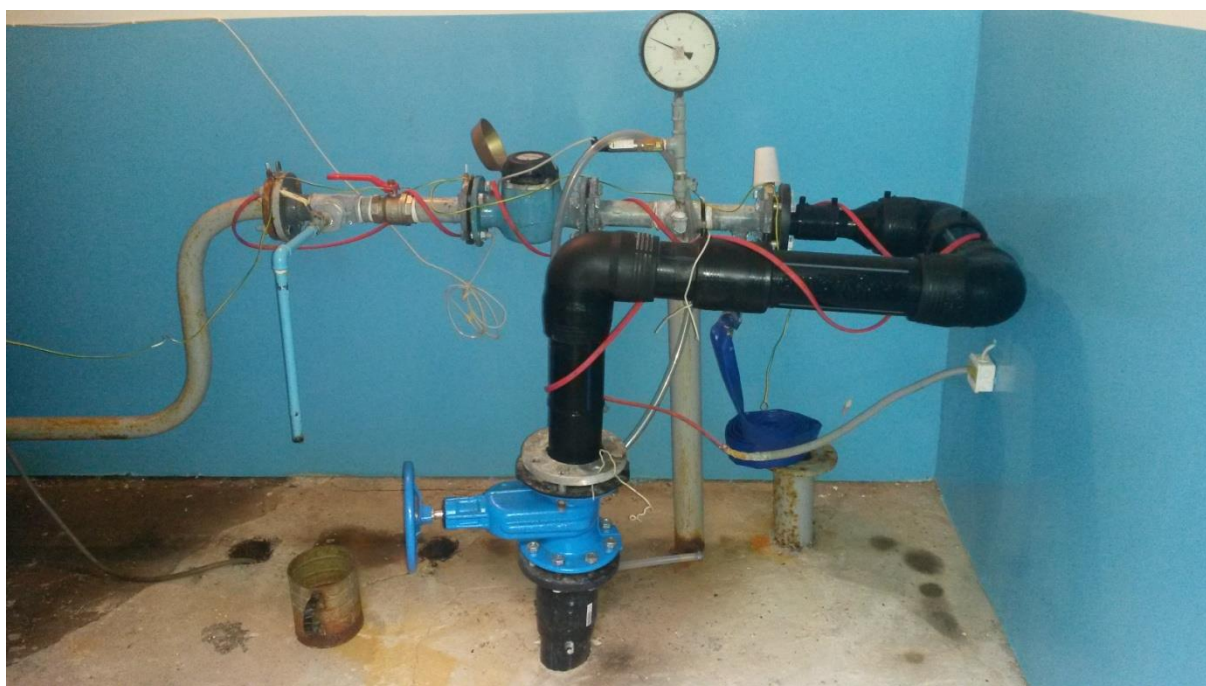
Foto 5.9 Siivertsi puurkaevpumpla sisevaade 1
