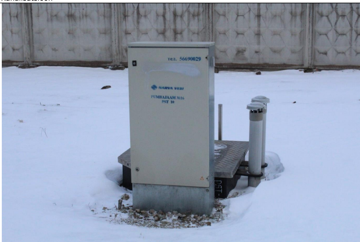
Foto 6.1 Kanalisatsiooni kompaktpumpla (10 tk)
