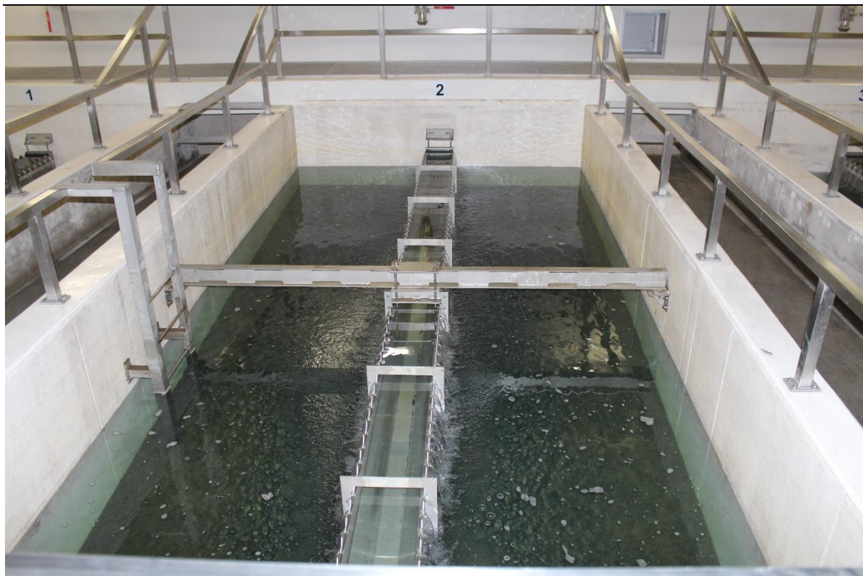
Foto 5.6 Vee töötlusjaama aktiivsöefiltrid.
